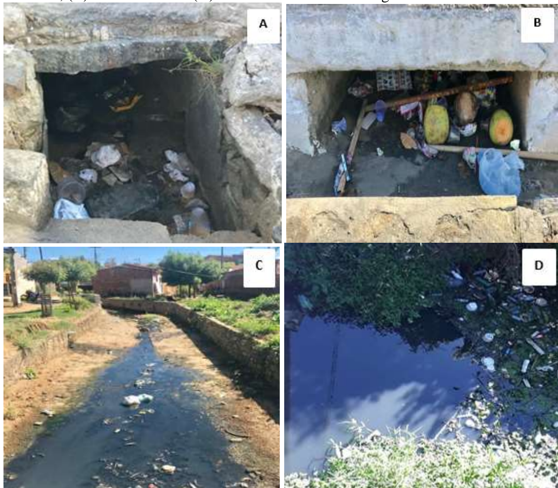
Figura 12 - Acúmulo de resíduos sólidos: (A) Rua Joaquim Costa, (B) Rua Coronel Juvêncio Carneiro, (C) Rua São José e (D) Avenida José Donato Braga
