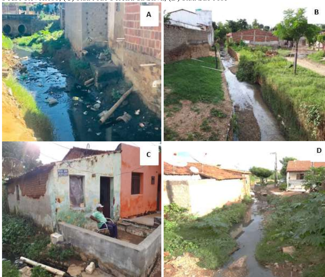
Figura 11 - Ligações clandestinas de esgoto no sistema de drenagem: (A) Rua Projetada, (B) Rua Pedro Revoltoso, (C) Rua João Pereira da Silva, (D) Rua São José
